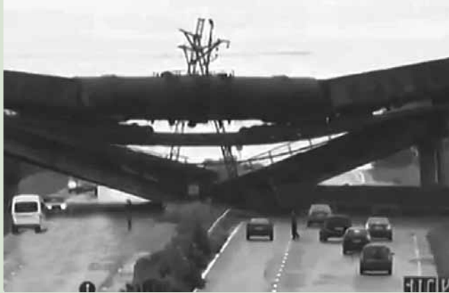
25. Juli 2014: Die Kiewer Faschisten haben die Eisenbahnbrücke über die Schnellstraße Slowjansk-Donetsk-Mariupol zerstört
